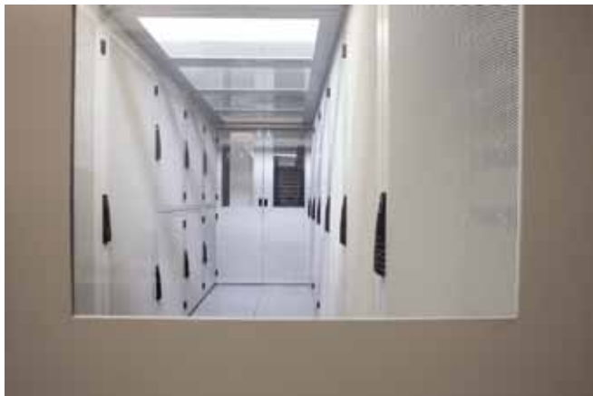
Blick in die Cold-Section-Kaltgangeinhausung von Schäfer IT-Systems im Rechenzentrum der HiHo GmbH in Wolfhausen.
